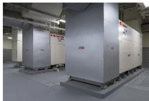
非常用発電機
